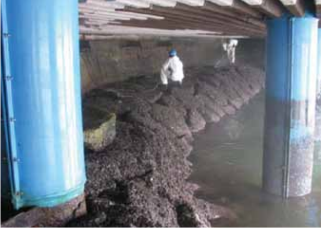
▲ الشكل رقم 31: قد يكون الوصول إلى الأجزاء السفلية من أرصفة الميناء أمرًا صعبًا وخطيرًا بالنسبة لفرق التنظيف نظرًا لقلّة المساحة العلوية والتهوية.
