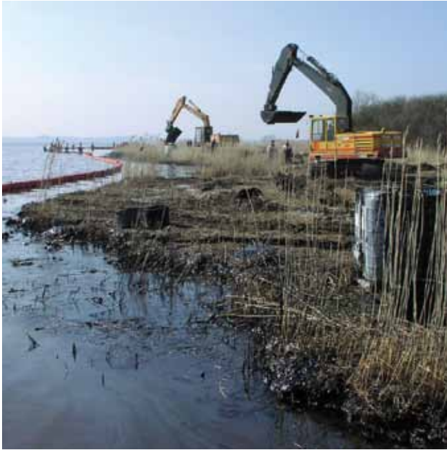
الشكل رقم 41: يمكن أن يؤدي استخدام الآلات الثقيلة على المناطق الحساسة من السواحل إلى أضرار إضافية كبيرة. في هذه الحالة، أعطيت الأولوية لاستعادة النفط الطافي بحرية على وجه السرعة.
