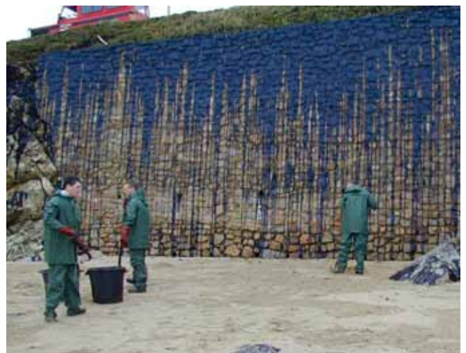
▲ 图 15：风暴潮过后海堤上出现的重度油类污染。
