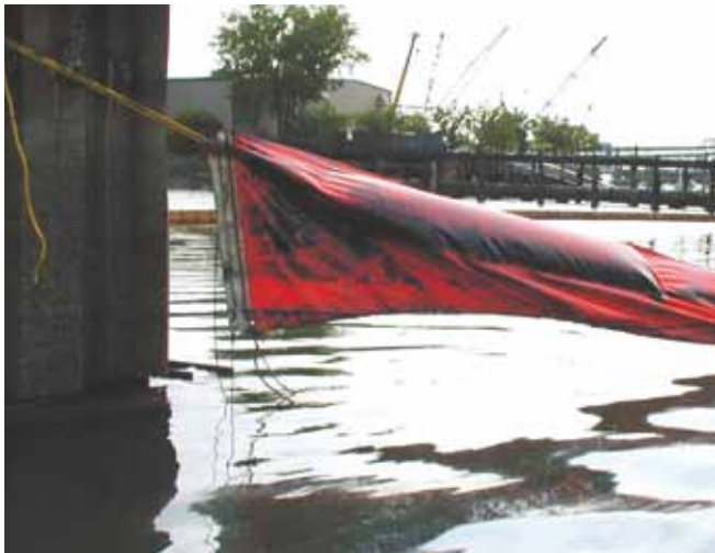
▲ 图 16: 使用长度不足的锚绳导致栅栏在低潮时悬空, 从而使油类能够从其下方流走。在整个潮汐周期内, 需要定期调整锚绳以使栅栏保持在有效的位置。在这种情况下使用滑动式锚定物将更为有效。
