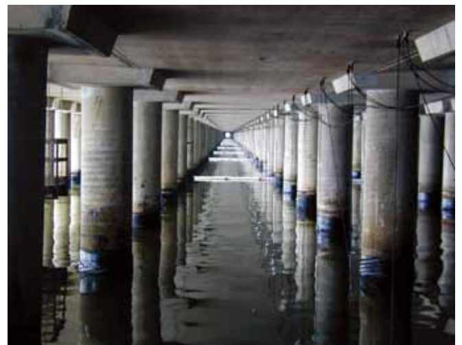
▲ 图 5：对于清理工作人员而言，由于头顶空间有限且没有空气流通，进入码头下面可能比较困难和危险。
