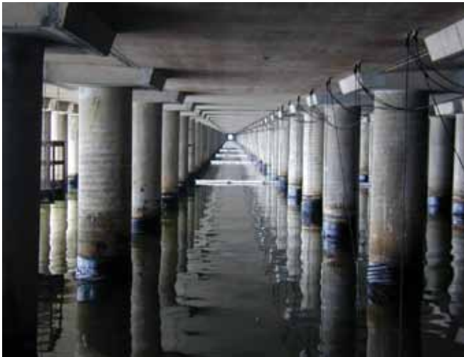
الشكل رقم 5: قد يكون الوصول إلى الأجزاء السفلية من أرصفة الميناء أمرًا صعبًا وخطرًا بالنسبة لفرق التنظيف نظرًا لقلة المساحة العلوية والتهوية.
