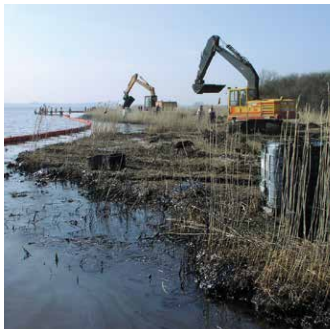
▲ 図41：海岸線の脆弱な地区で重機を使用すると、かなりの二次的な損害を生じる場合がある。この写真の例では、浮遊油を迅速に回収する必要性が優先事項とされた。
