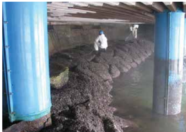
▲ 図31：清掃チームが波止場の下へ近付くことは、空間と換気の不足のため、困難で危険な場合がある。
