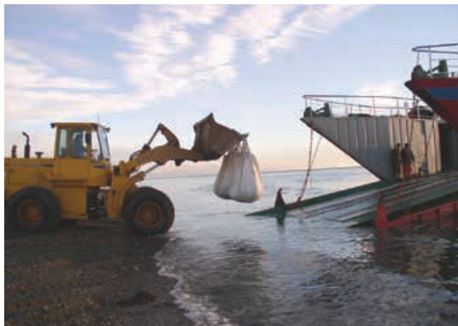
▲ Figura 11: las bolsas más pequeñas de residuos contaminados por hidrocarburos se reúnen en sacos "big bag" de una tonelada que se transportan hasta una embarcación de desembarco para la retirada de una costa aislada.
