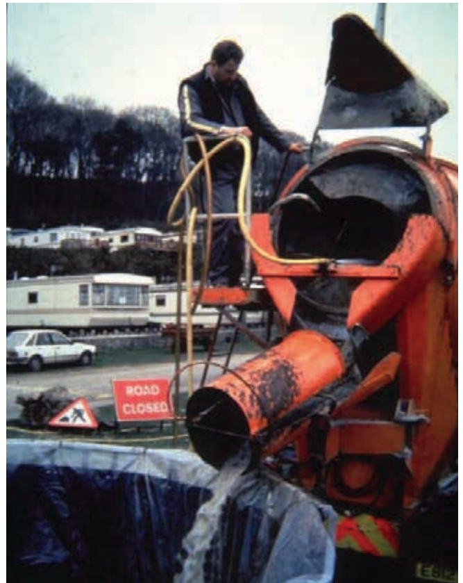
▲ Figura 24: liberación de efluentes desde un camión hormigonera después de lavar guijarros y pequeños cantos rodados.
