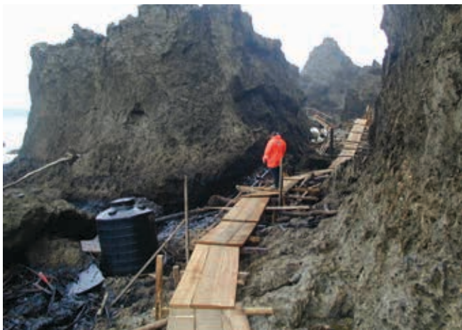
▲ Figura 35: en costas rocosas, existe la opción de construir pasos provisionales para minimizar los riesgos para los operarios.
