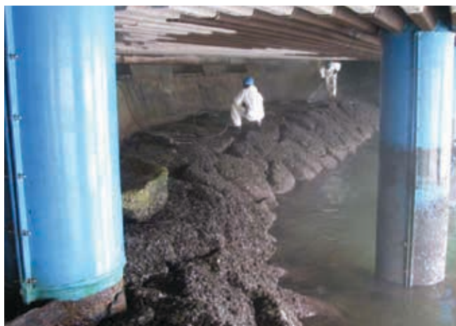
▲ Figura 31: Puede que la falta de espacio libre y de ventilación debajo de embarcaderos impida a los operarios de limpieza trabajar de forma fácil y segura.
